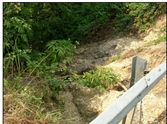
...la frana vista da sopra.
