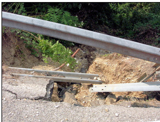
...quello che rimane del guard rail...
